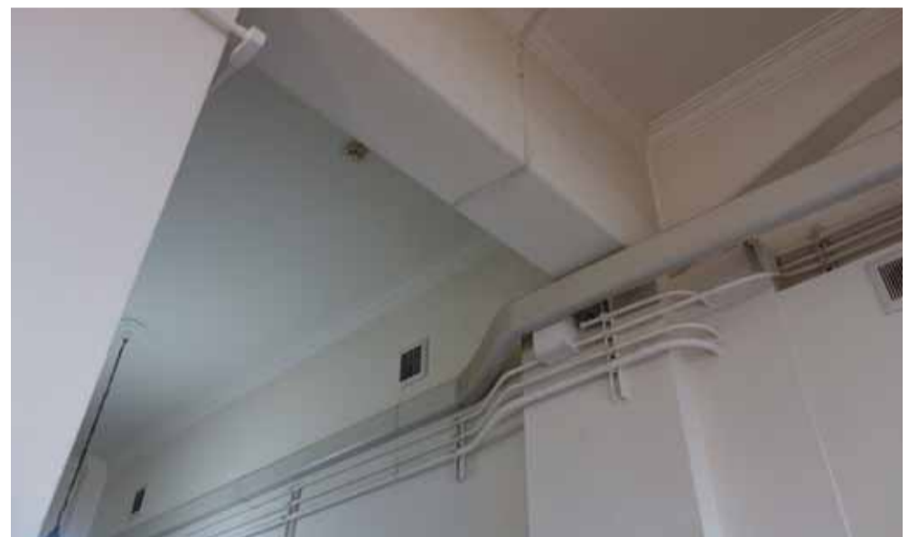
配線とダクト
