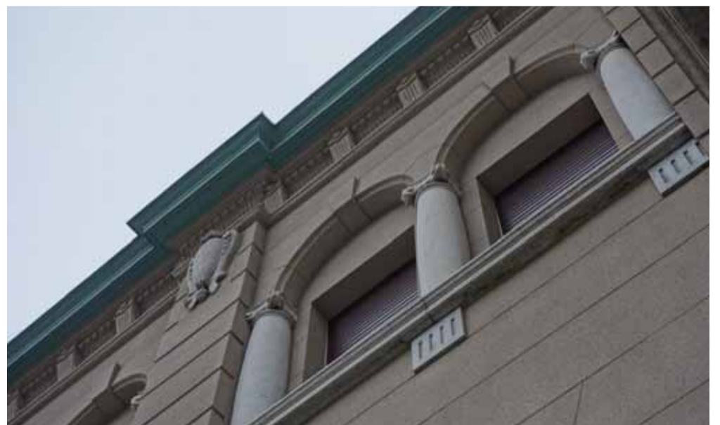
ホイッスル上部のモルタル剥落、およびデンティルの補修
