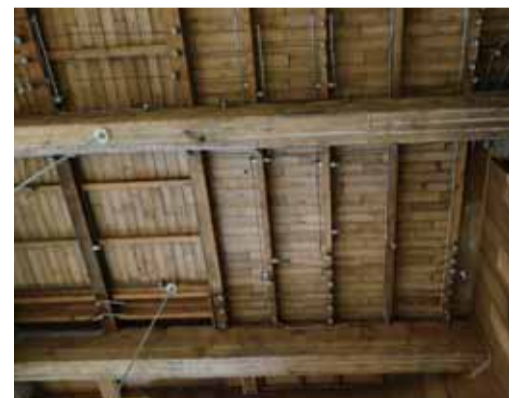
碇子引き配線の天井
