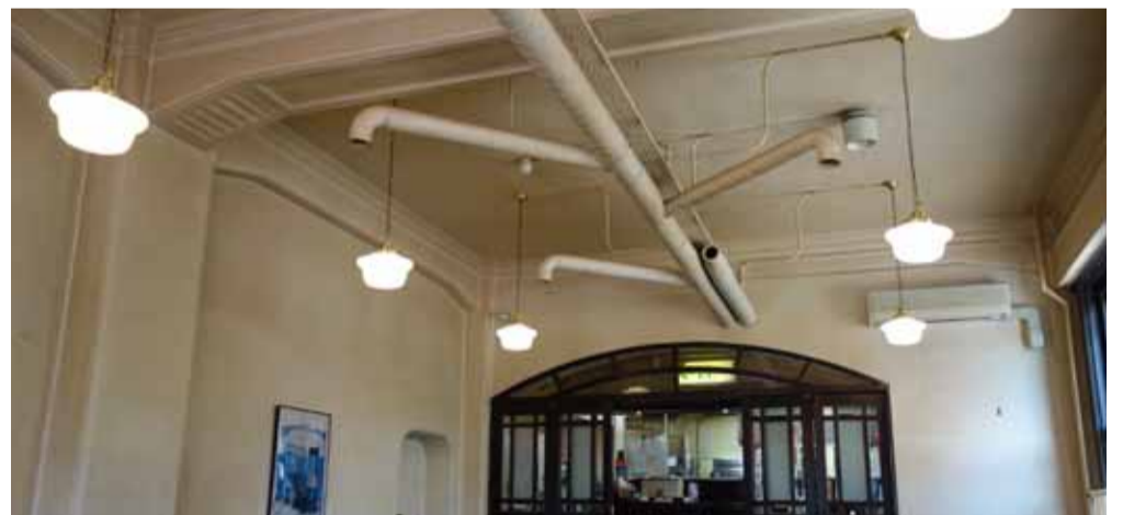
ダクトと配線が天井に露出. しても自然
