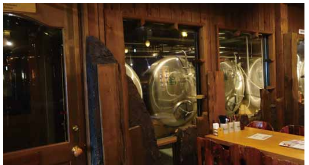
第二次発酵タンク
